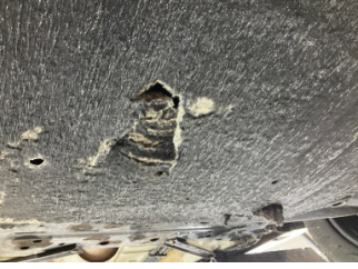
Motor, Alt muhafaza > Hasarlı
