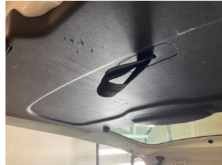
Döşemeler/Kapaklar, Döşemeler/Kapaklar > Çizik
