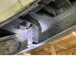
Tampon, arka, Bağlantı ayağı > Kırılmış
