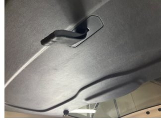
Döşemeler/Kapaklar, Döşemeler/Kapaklar > Deforme Olmuş
