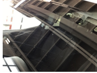
Camlar, Ön cam > Çatlak
