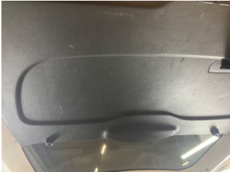
Döşemeler/Kapaklar, Döşemeler/Kapaklar > Çizik
