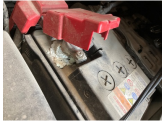
Elektrik donanımı/Pano, Akü > Onaysız
