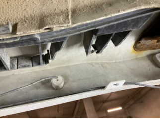
Tampon, arka, Bağlantı ayağı > Hasarlı
