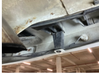
Tampon, arka, Bağlantı ayağı > Hasarlı
