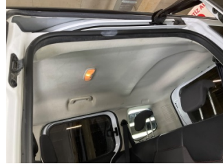
Döşemeler/Kapaklar, Döşemeler/Kapaklar > Deforme Olmuş
