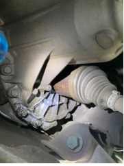
Şanzıman, Şanzıman > Yağ Kaçağı
