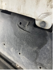
Tampon, ön, Tampon koruyucu orta > Hasarlı
