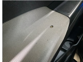
Döşemeler/Kapaklar, Döşemeler/Kapaklar > Yakıcı Madde İle Zarar Görmüş
