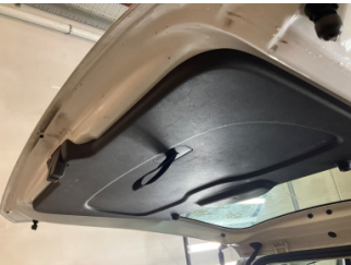
Döşemeler/Kapaklar, Döşemeler/Kapaklar > Çizik
