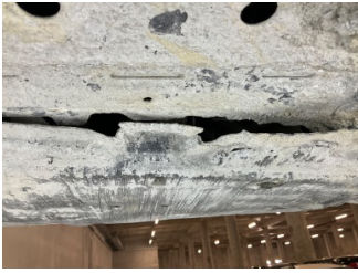
Motor, Alt muhafaza > Hasarlı
