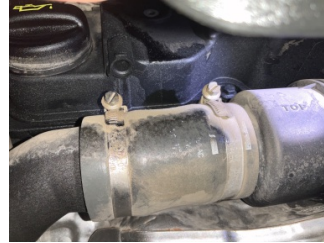
Motor, Motor > Yağ Kaçağı
