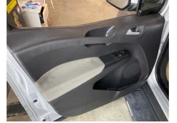
Döşemeler/Kapaklar, Döşemeler/Kapaklar > Deforme Olmuş
