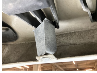
Tampon, arka, Bağlantı ayağı > Kırılmış
