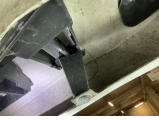
Tampon, arka, Bağlantı ayağı > Kırılmış
