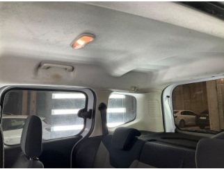
Döşemeler/Kapaklar, Döşemeler/Kapaklar > Kirlenmiş
