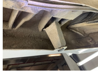
Tampon, arka, Bağlantı ayağı > Kırılmış
