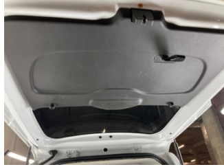
Döşemeler/Kapaklar, Döşemeler/Kapaklar > Çizik
