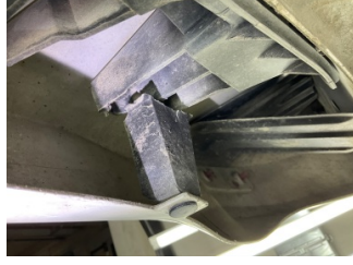
Tampon, arka, Bağlantı ayağı > Kırılmış
