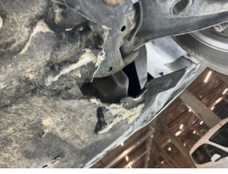
Motor, Alt muhafaza > Hasarlı
