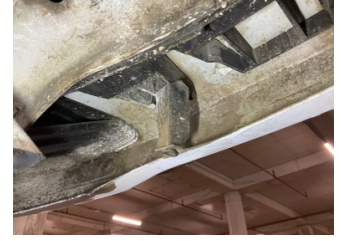
Tampon, arka, Bağlantı ayağı > Hasarlı
