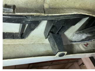
Tampon, arka, Bağlantı ayağı > Hasarlı
