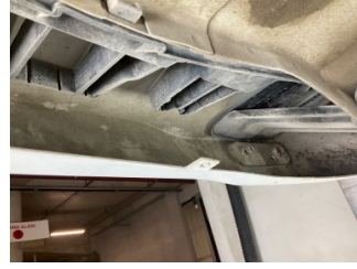
Tampon, arka, Bağlantı ayağı > Hasarlı
