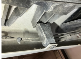
Tampon, arka, Bağlantı ayağı > Hasarlı
