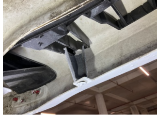
Tampon, arka, Bağlantı ayağı > Hasarlı
