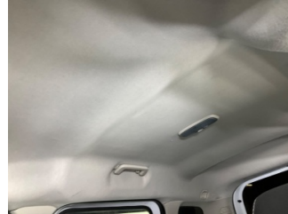
Döşemeler/Kapaklar, Döşemeler/Kapaklar > Deforme Olmuş
