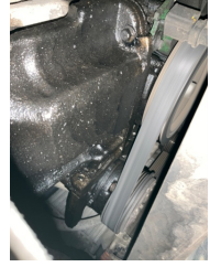
Motor, Motor > Yağ Kaçağı
