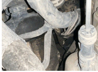
Motor, Motor > Yağ Kaçağı
