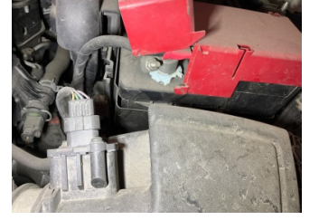
Elektrik donanımı/Pano, Akü > Onaysız
