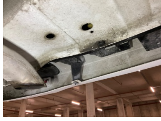
Tampon, arka, Bağlantı ayağı > Hasarlı
