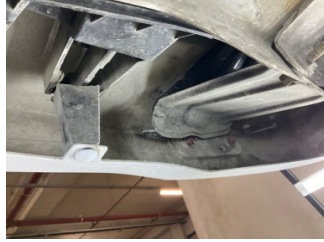
Tampon, arka, Bağlantı ayağı > Hasarlı
