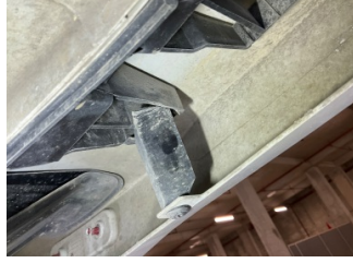
Tampon, arka, Bağlantı ayağı > Kırılmış
