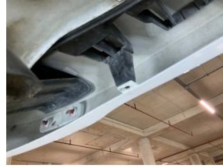
Tampon, arka, Bağlantı ayağı > Sabitlemesi Hatalı
