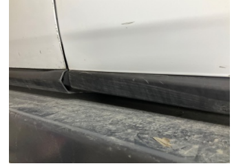
Marşbiyel, sol, Marşbiyel, sol > Sabitlemesi Hatalı
