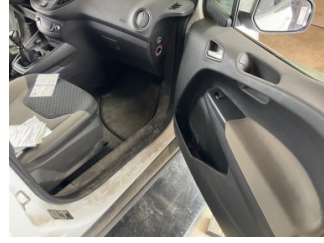
Döşemeler/Kapaklar, Döşemeler/Kapaklar > Deforme Olmuş
