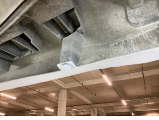
Tampon, arka, Bağlantı ayağı > Kırılmış
