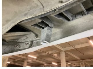
Tampon, arka, Bağlantı ayağı > Kırılmış
