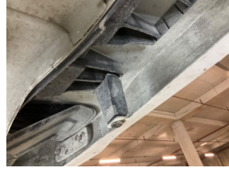
Tampon, arka, Bağlantı ayağı > Hasarlı
