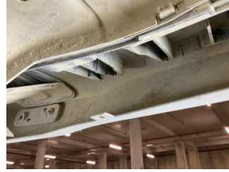
Tampon, arka, Bağlantı ayağı > Hasarlı
