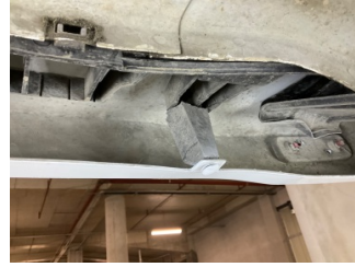
Tampon, arka, Bağlantı ayağı > Hasarlı
