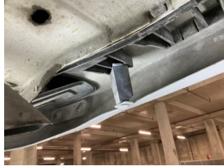
Tampon, arka, Bağlantı ayağı > Hasarlı
