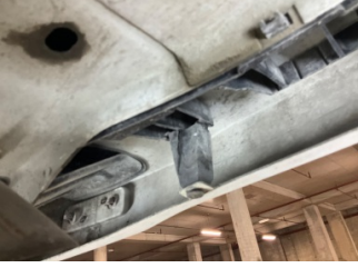
Tampon, arka, Bağlantı ayağı > Kırılmış
