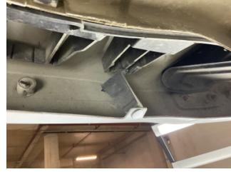
Tampon, arka, Bağlantı ayağı > Hasarlı
