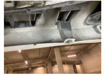
Tampon, arka, Bağlantı ayağı > Hasarlı
