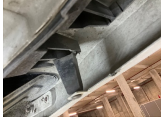
Tampon, arka, Bağlantı ayağı > Hasarlı
