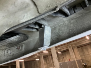
Tampon, arka, Bağlantı ayağı > Hasarlı
