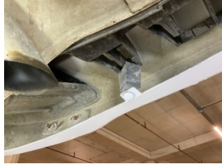
Tampon, arka, Bağlantı ayağı > Hasarlı
