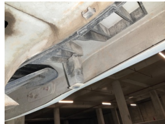
Tampon, arka, Bağlantı ayağı > Hasarlı
