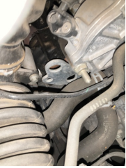
Motor, Motor > Yağ Kaçağı
