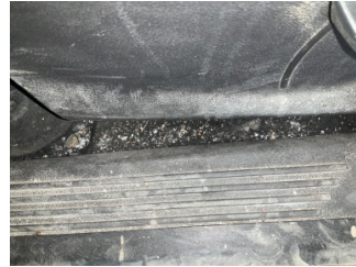
Döşemeler/Kapaklar, Döşemeler/Kapaklar > Yakıcı Madde ile Zarar Görmüş
