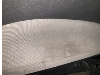
Döşemeler/Kapaklar, Döşemeler/Kapaklar > Yakıcı Madde ile Zarar Görmüş
