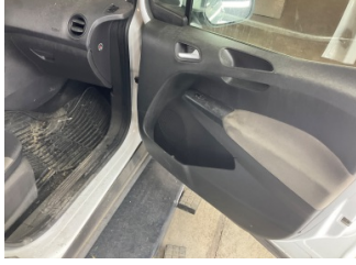
Döşemeler/Kapaklar, Döşemeler/Kapaklar > Deforme Olmuş
