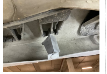
Tampon, arka, Bağlantı ayağı > Hasarlı
