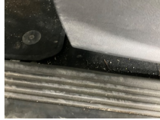
Döşemeler/Kapaklar, Döşemeler/Kapaklar > Yakıcı Madde ile Zarar Görmüş
