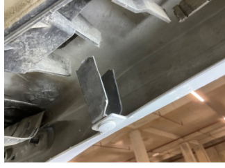
Tampon, arka, Bağlantı ayağı > Hasarlı
