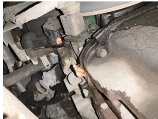
Motorsoğutması, Soğutma sıvısı > Sızdırıyor
