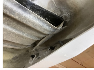
Tampon, arka, Bağlantı ayağı > Hasarlı
