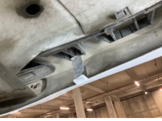
Tampon, arka, Bağlantı ayağı > Hasarlı
