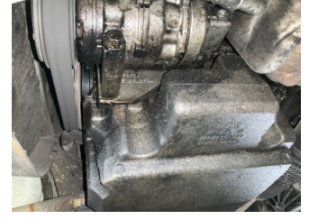
Motor, Motor > Yağ Kaçağı
