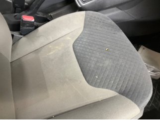
Döşemeler/Kapaklar, Döşemeler/Kapaklar > Yakıcı Madde Ile Zarar Görmüş
