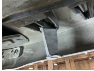
Tampon, arka, Bağlantı ayağı > Hasarlı
